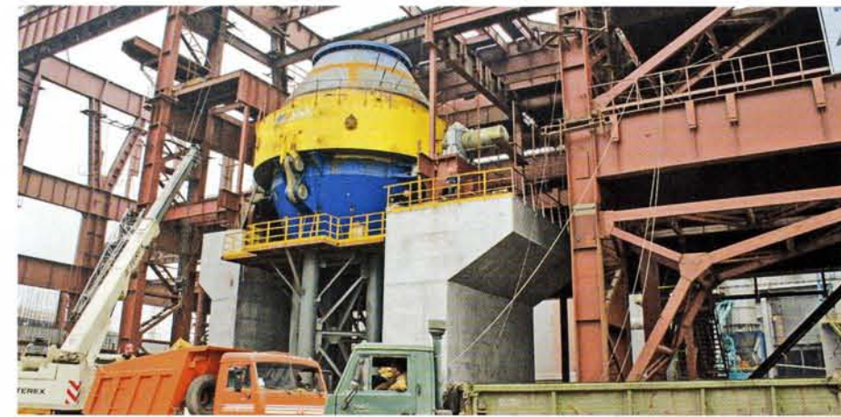
Существенной особенностью возведения нового кислородно-конвертерного цеха Алчевского МК были сжатые сроки строительства – 18 месяцев от момента установки первой колонны. На территории Украины это первый проект такого масштаба, реализованный в такой рекордный срок.
